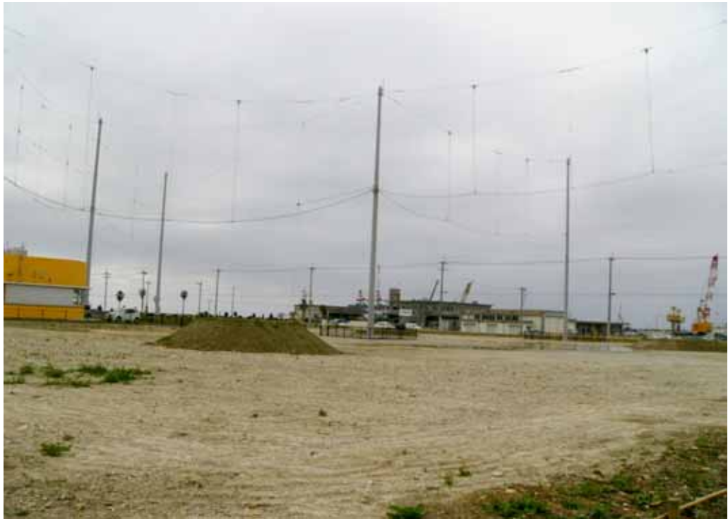
中短波、短波帯無線通信用水平ダブレットアンテナ天張状況
